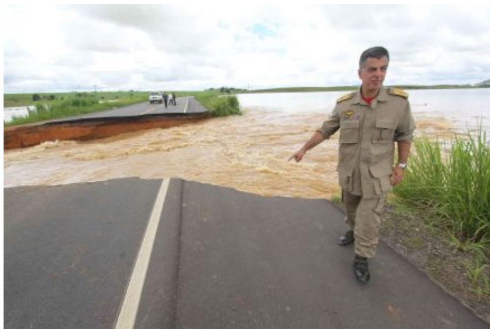
O rompimento de um dique abriu uma cratera de 20 metros na rodovia BR-356 que foi destruída, interrompendo o tráfego (ANTÔNIO CRUZ/FOLHADAMANHÃ)
